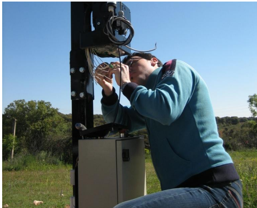
Figura 17: Cableado de control de los motores.
