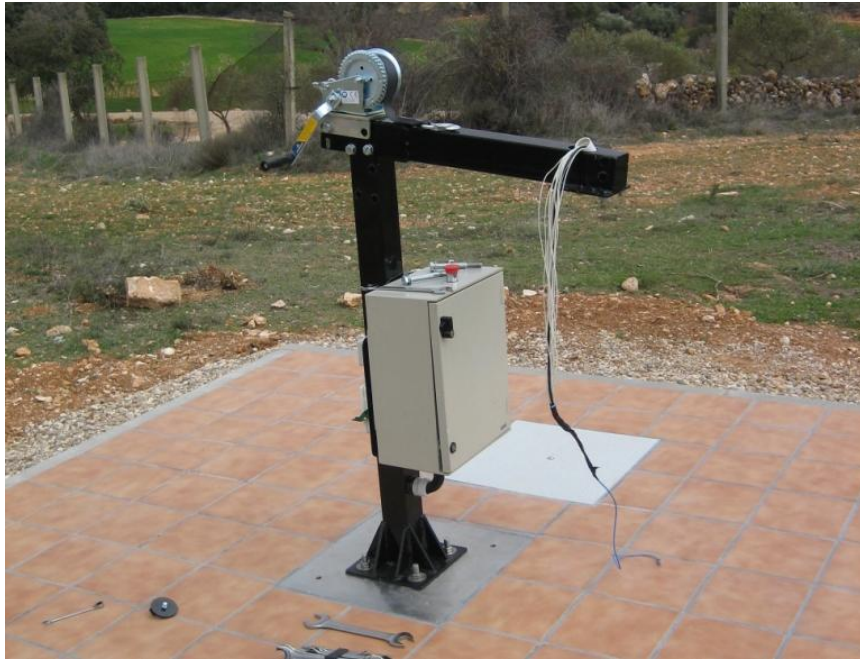
Figura 13: Instalación de la estructura que permite izar los motores de azimut y elevación.
