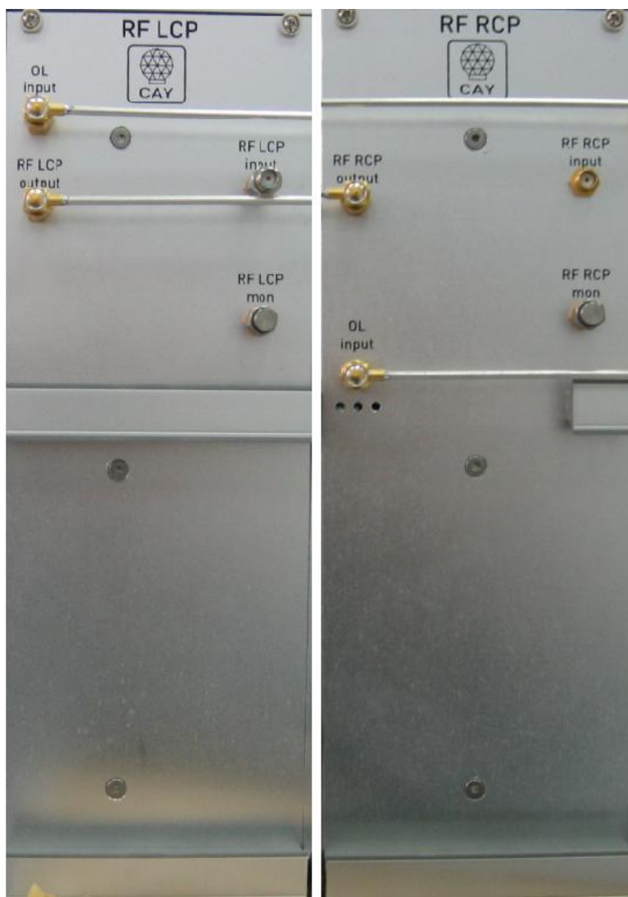
Figura 29: frontal montado de los módulos de RF
