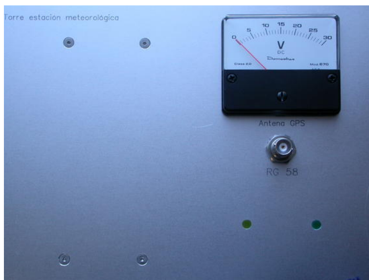
Figura 9: Frontal del panel de conexiones en la sala de backends correspondiente a la torre meteorológica. El tope de escala del voltímetro es incorrecto y donde marca 30 V debe marcar 1 V. El LED izquierdo amarillo muestra el estado de las alarmas, y el verde el de alimentación del receptor de FO.
