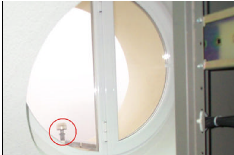
Figura 21. Ubicación temporal de la antena GPS en la ventana de la sala de backends
