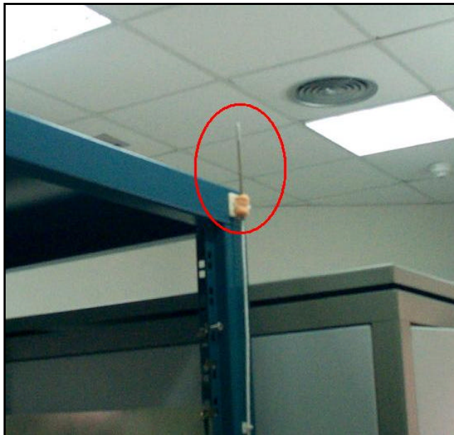
Figura 15. Sonda PT100 instalada en la sala de backends
