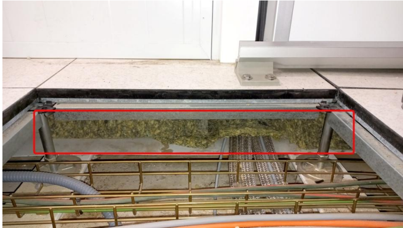
Figura 15. Detalle del aislamiento de la sala de compresores bajo el suelo.
