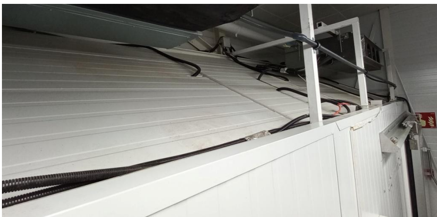
Figura 12. Aislamiento del techo de la sala de compresores.
