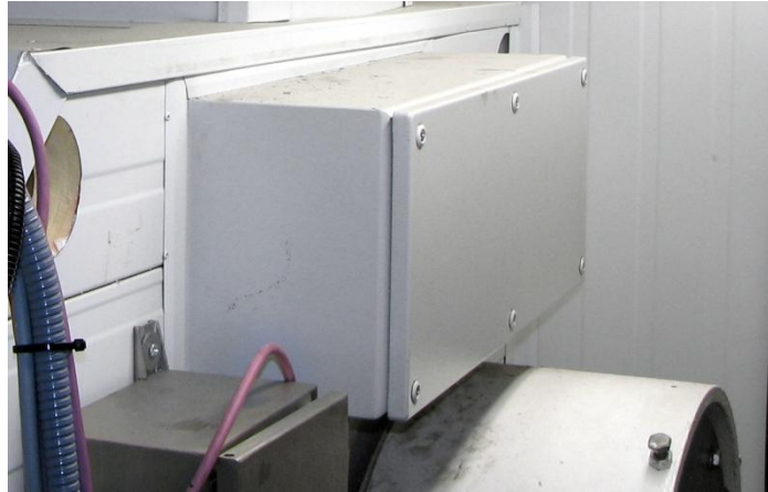
Figura 9. Detalle del aislamiento de las cajas con los inclinómetros.
