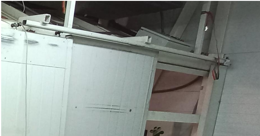
Figura 3. detalle del mecanismo de cierre de la puerta de la sala de compresores.
