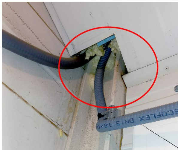
Figura 16. Detalle del aislamiento de huecos en la sala de compresores.
