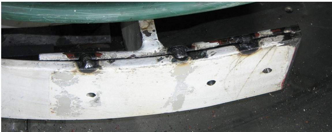
Ilustración 15. Pletina de interfase con el chaflán y los puntos de soldadura ya completados.
