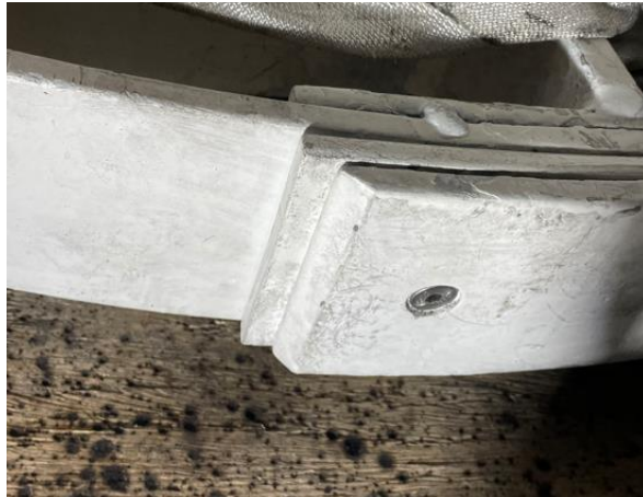
Ilustración 19. Escalón generado en la unión al tubo.
