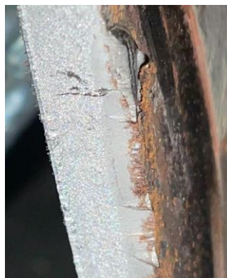
Ilustración 7. Zona de la rotura ampliada.
