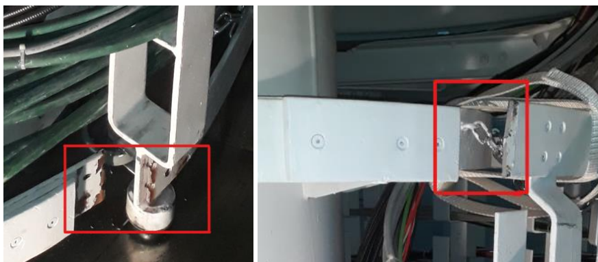
Ilustración 4. Rotura detectada en 2020 en ambas pletinas. a) Pletina inferior. b) Pletina superior.
