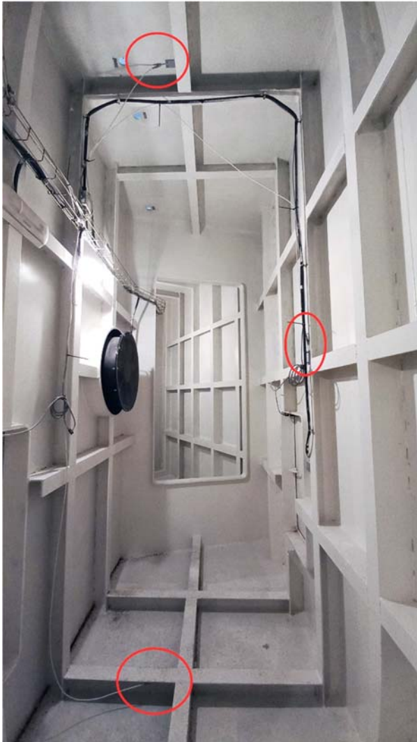
Sensores en la viga anular
