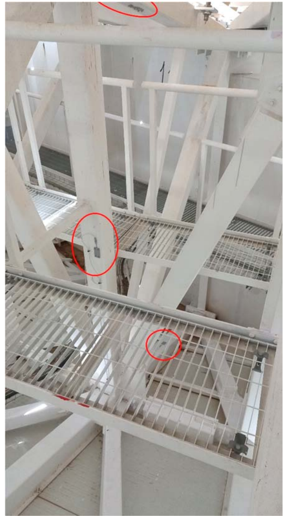
Sensores en la cercha exterior
