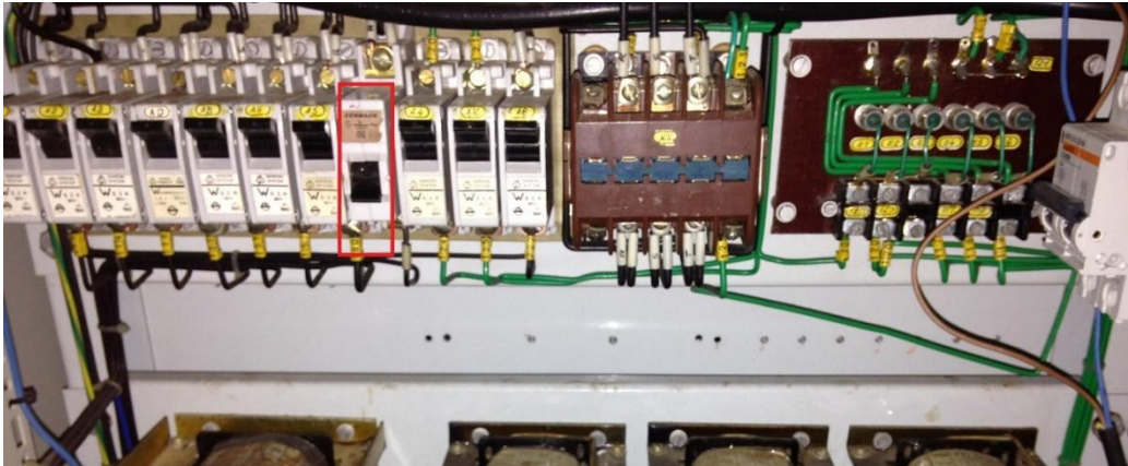
Figura A.1.8: Magnetotérmico del motor de seguimiento (velocidad constante ajustada por un variador instalado en la parte trasera del bastidor) para la compensación de la rotación de la tierra, marcado con el recuadro rojo.
