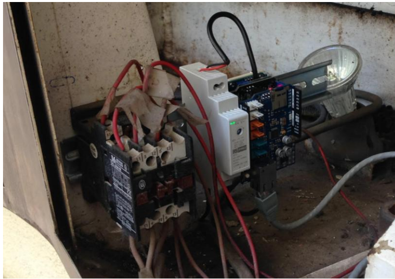
Figura 2.2: Instalación del módulo arduino fijo. Se ha instalado en un carril DIN, junto al contactor trifásico que enciende el grupo de presión hidráulico, encima de la botonera de control.
