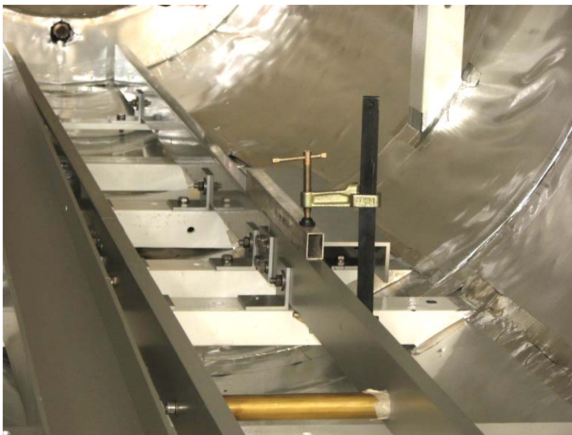
Figura 17. Alineamiento de la superficie de rodadura. El raíl más levantado corresponde al segundo tramo.
