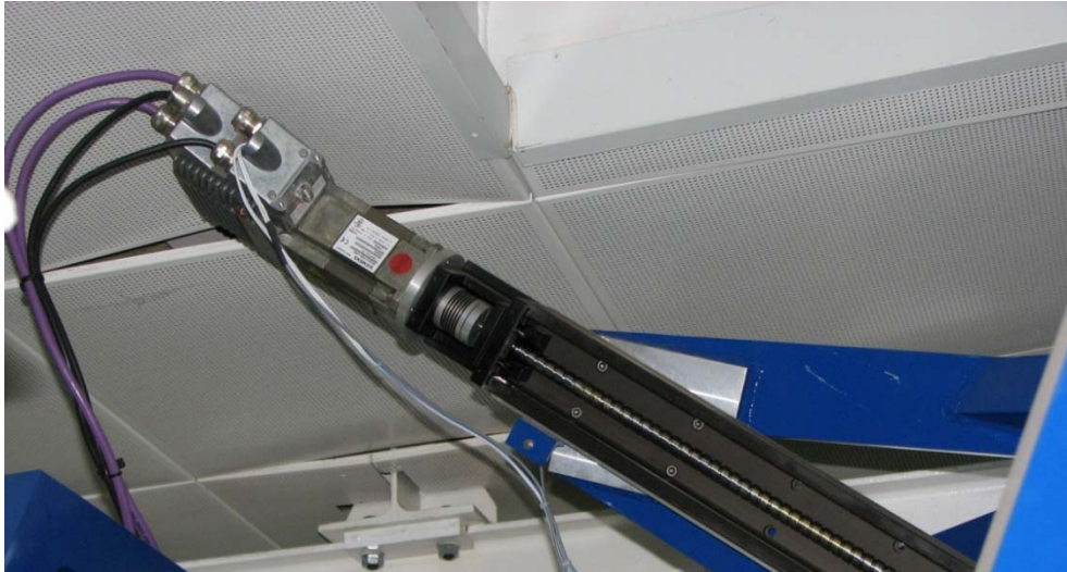
Figura 1. Situación original del servomotor del casquete parabólico.
