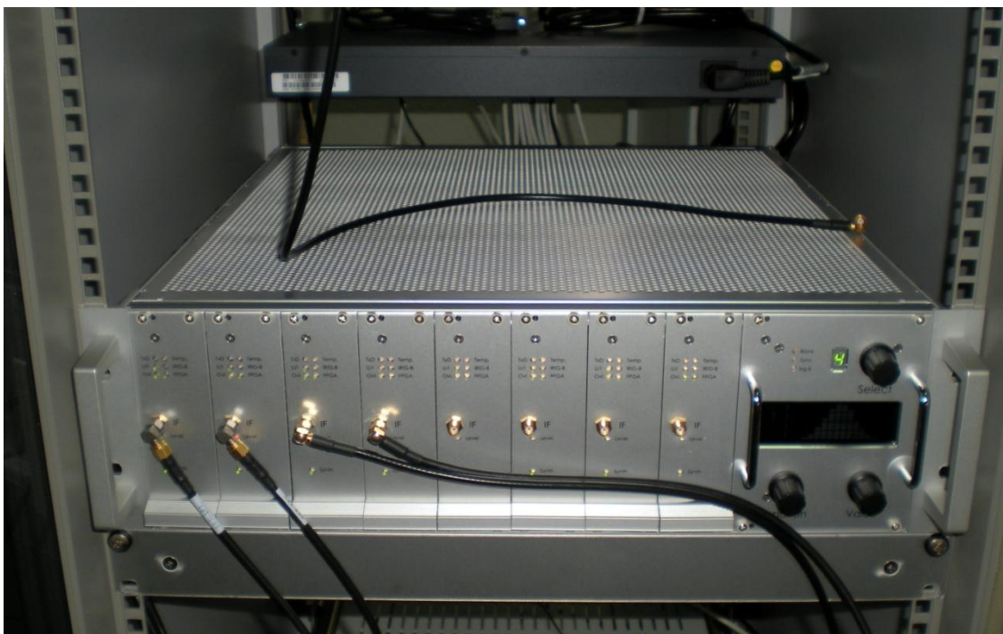
Figura 1: Espectrómetro FFTS instalado en la sala de backends del radiotelescopio de 40 metros.
